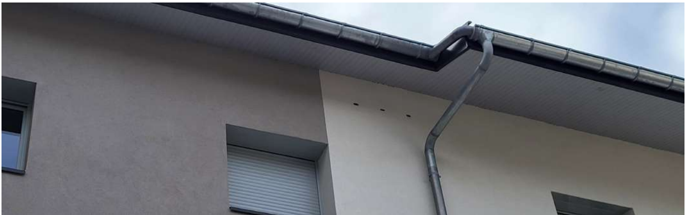
Nichour triple à martinets intégré dans l'isolant sur le site pilote de Grand Aigueblanche (73) © Ilan Badaoui
