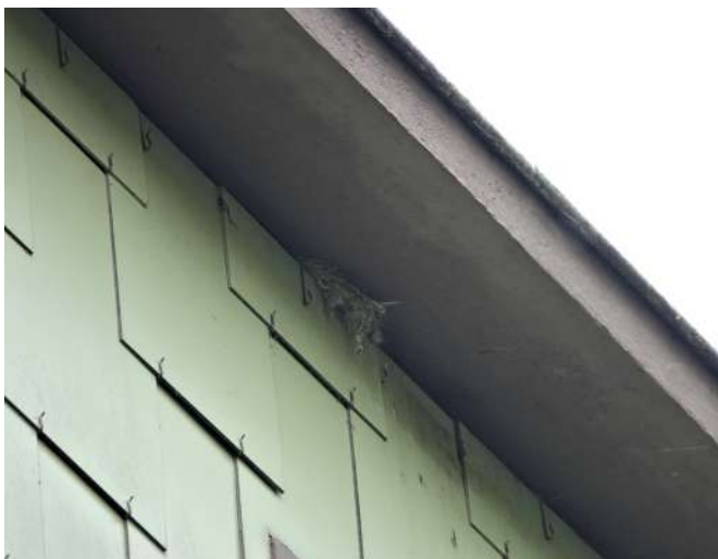
Nid de moineaux dans l'espace entre l'isolant et le toit © Maëva Felten
